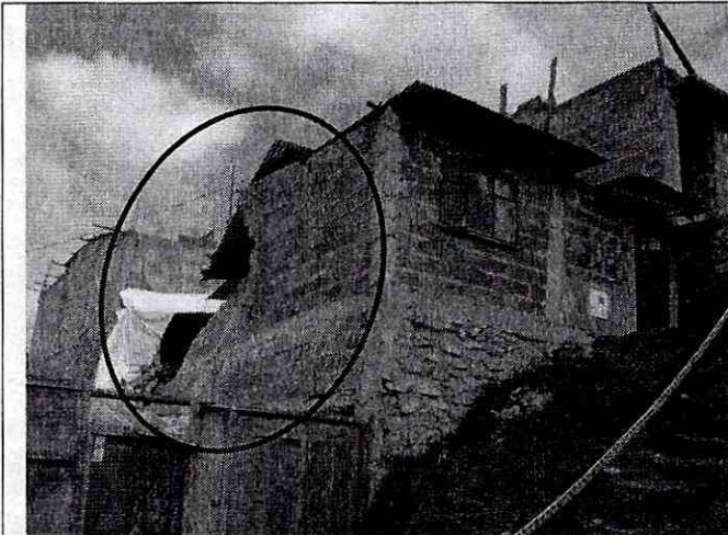
Foto 3. Colapso del muro de cerramiento del costado sur del predio de la Carrera 73C No. # 77 – 33 Sur donde habita el señor Wistón Torres y familia
