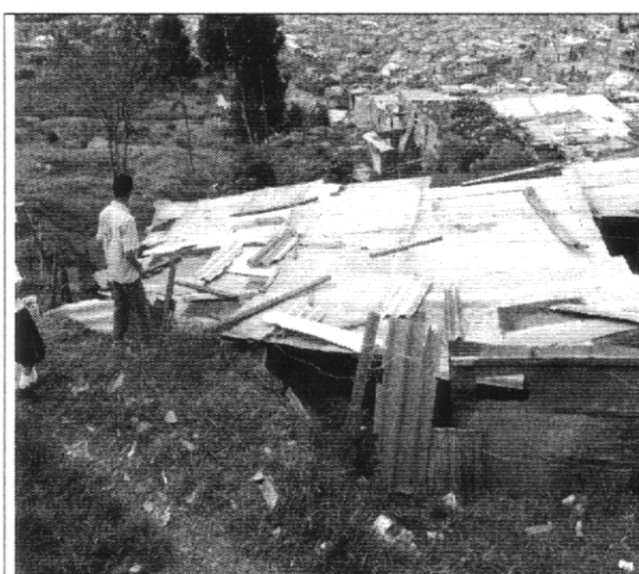
Foto 1. Vivienda donde habita la señora Ana Zulay Cerrato localizada la cual se encuentra emplazada en una zona de protección por procesos de remoción en masa.
