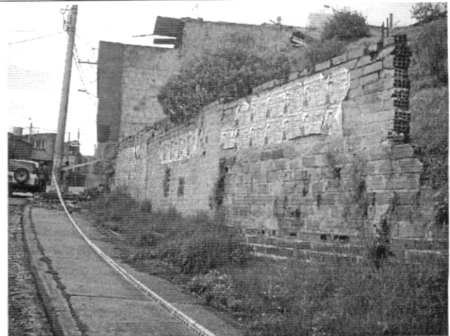
Fotografía 4. Vista lateral del muro en donde se evidencian colapsos anteriores.
