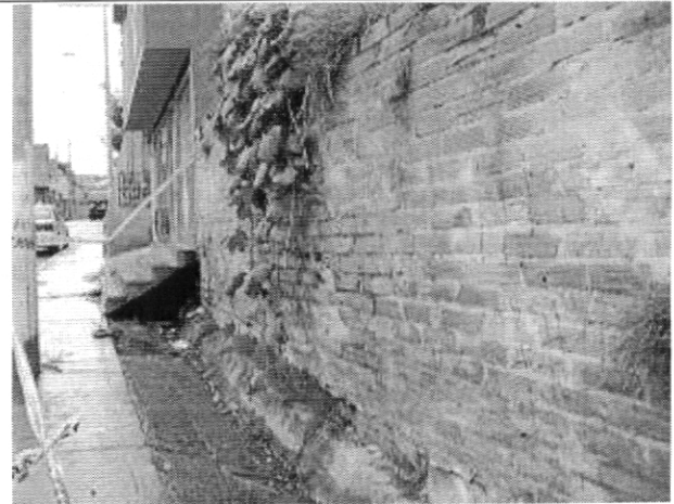
Fotografía 2. Vista lateral del muro (en julio de 2006), puede apreciarse la pérdida de verticalidad y el agrietamiento del muro.
