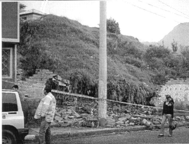
Fotografía 3. Colapso parcial del muro en los primeros 10m del costado Sur.
