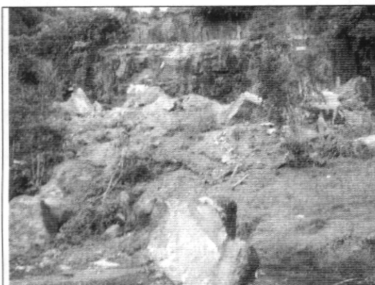
Foto 1. Vista frontal escarpe rocoso, evidencia de desprendimiento de bloques.
