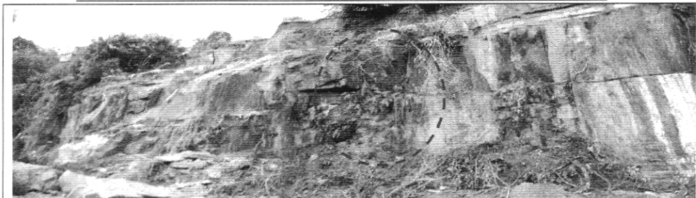
Foto 3. Intenso fracturamiento del macizo rocoso, presencia de raíces y humedad al interior de las discontinuidades.
