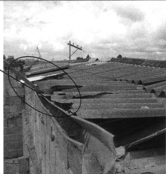
Foto 5. Partes del fuselaje del avioneta donde posiblemente impactó inicialmente Cubierta del predio que quedó afectada, ubicada en el sector del patio interior de la vivienda con nomenclatura Calle 24 F #102 A 20
