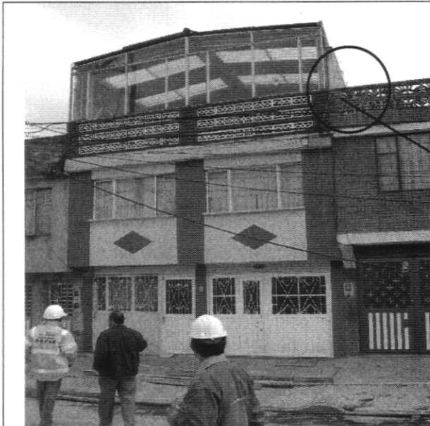
Foto 4. Fachada principal de la vivienda con nomenclatura Calle 24 F #102 A 20, donde se observó una leve afectación en el tercer nivel de la misma, sin que comprometa su estabilidad y/o habitabilidad en el mediano plazo, ante cargas habituales de servicio.
