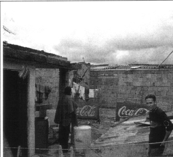
Foto 7. Tercer nivel de la vivienda con nomenclatura Carrera 102 A # 24 F 11 donde se afectó uno de los muros de cerramiento y divisorio con los predios 2 y 5 del esquema.
