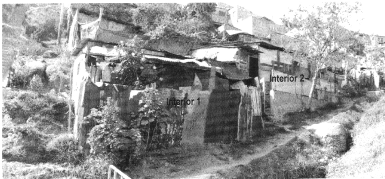
Fotografía 1. Localización del predio de la Carrera 18B No. 69D-03 Sur, se identifican los Interiores 1 y 2. Nótase su ubicación respecto al Caño El Baúl y la inclinación del árbol aledaño al Interior 2, que sugiere reptación en el terreno
