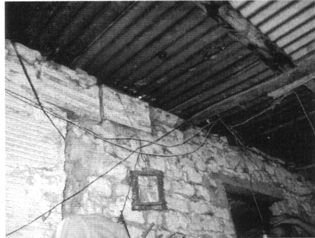
Fotografía 3. Vista de los agrietamientos en los muros internos en mampostería del Interior 2. Nótese el contacto entre los diferentes tipos de ladrillos que componen el muro
