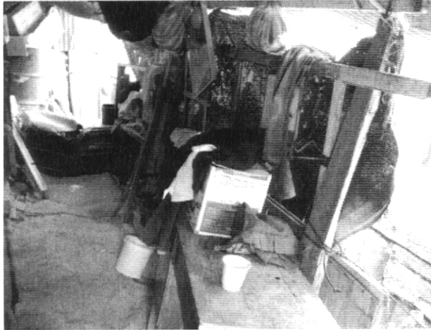
Fotografía 2. Vista de la pérdida de verticalidad en los elementos estructurales en madera de la parte delantera del Interior 1. Nótese su deficiente amarre estructural
