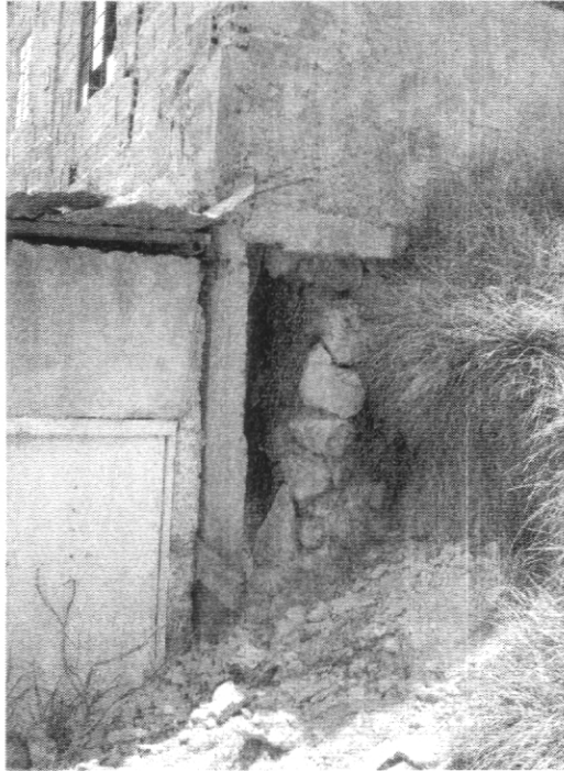
Fotografía 4. Detalle de la contención deficiente del relleno de cimentación de la vivienda de la Calle 81D Sur No. 19-21. Se observa que la vivienda en este costado se encuentra parcialmente sin terreno de soporte
