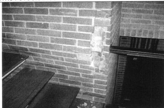
Foto 2. Se observa el aplastamiento en el muro del foso del ascensor, posiblemente porque los muros están asumiendo presiones y/o compresiones para los cuales posiblemente no fueron diseñados y/o construidos, situación que con base en la inspección visual no es posible determinar.
