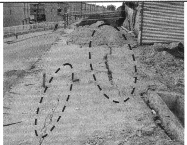
Foto 2. Grietas de tracción ubicadas en la parte alta (corona) del talud ubicado al costado sur-oriental del sector localizado en la Transversal 139 entre la Calle 142A y la Calle 142C.
