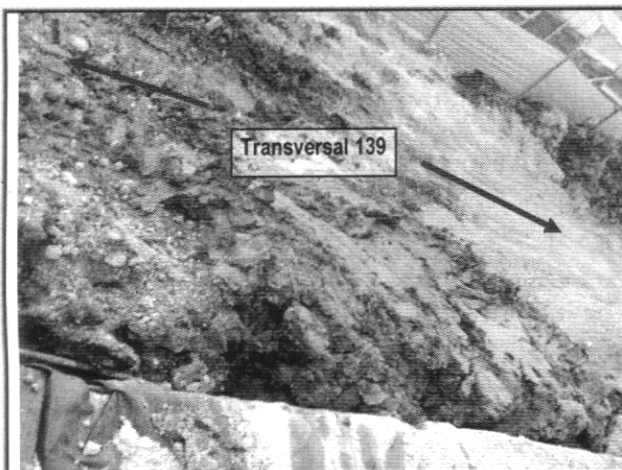
Foto 1. Desprendimiento de material proveniente del talud de corte ubicado en el costado sur-oriental del sector localizado en la Transversal 139 entre la Calle 142A y la Calle 142C.
