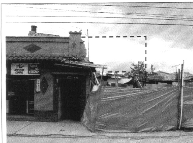
Fotografía 1. Se observa el frente del predio ubicado en la Calle 18 # 103A - 40. Fotografía tomada después de la remoción de escombros y de la cubierta que colapsó parcialmente.
