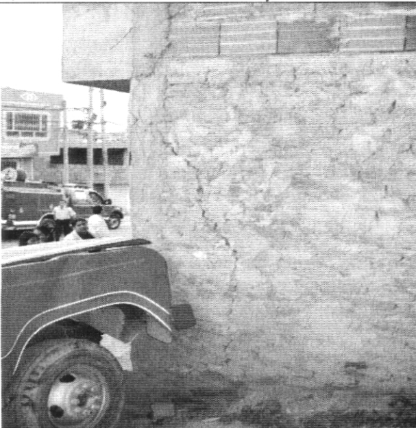
Fotografía 3. Se observa el agrietamiento del muro del costado sur de la vivienda ubicada en la Carrera 17A # 74B - 16 Sur, a causa del impacto.
