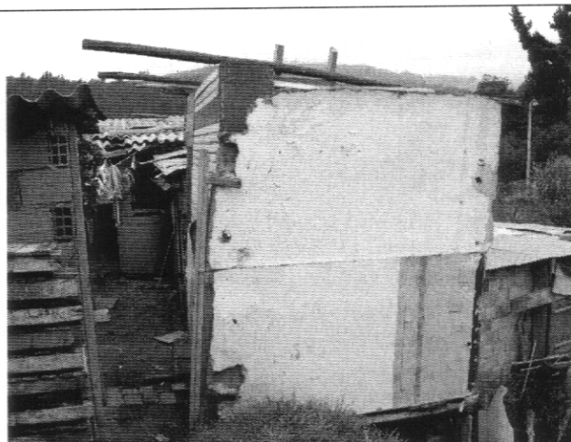
Fotografía 2. Vista de la parte frontal de la Manzana 1 Lote 11 la cual presentó anegación.
