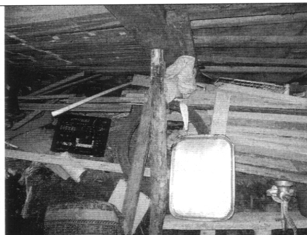
Fotografía 4. Interior de la vivienda de la Manzana 1 Lote 10. Detalle de las deficiencias constructivas asociadas con la ausencia de amarre estructural.
