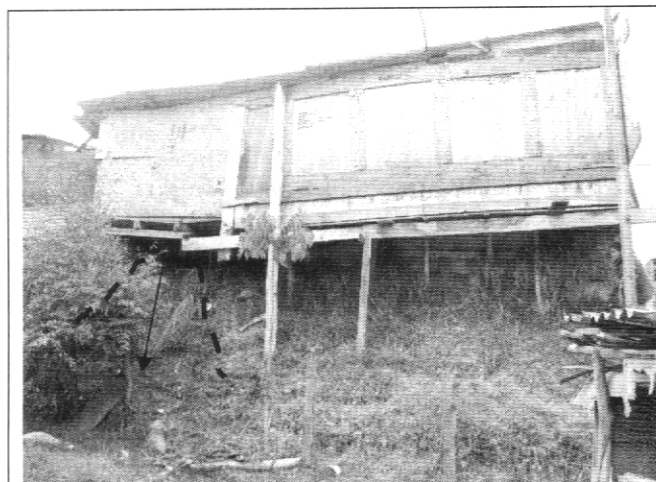
Fotografía 3. Vista del costado occidental de la vivienda de la Manzana 2 Lote 12 donde habita la señora María Isabel Garzón y su familia. Se presentó flujo de tierras que generó pérdida de suelo de cimentación.
