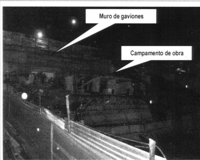
Fotografía 1. Vista del talud del costado occidental de la excavación que se adelanta en el predio de la Calle 138 # 75 - 24, del barrio Atenas en la Localidad de Suba, donde se presentó la falla.
