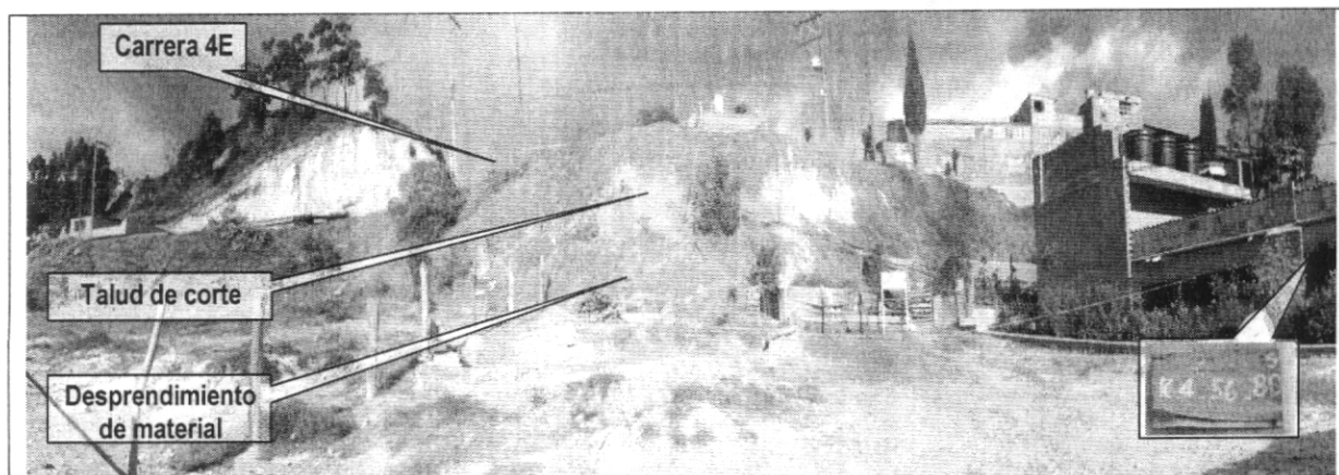
Foto 1. Vista desde parte baja del talud de corte afectado.
