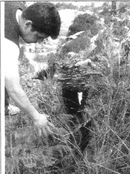
Fotografía 3. Detalle de la grieta en la parte superior del macizo. Presenta una abertura aproximada de 20cm
