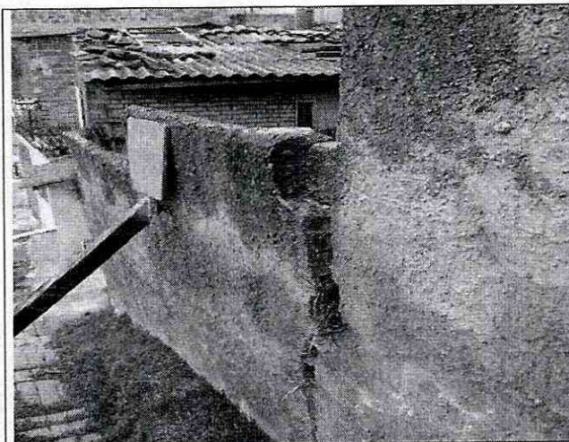
Fotografía 1. Se observa la pérdida de verticalidad y el agrietamiento del muro de cerramiento en la parte posterior del predio ubicado en la Cra 4 # 7 - 59 Sur.
