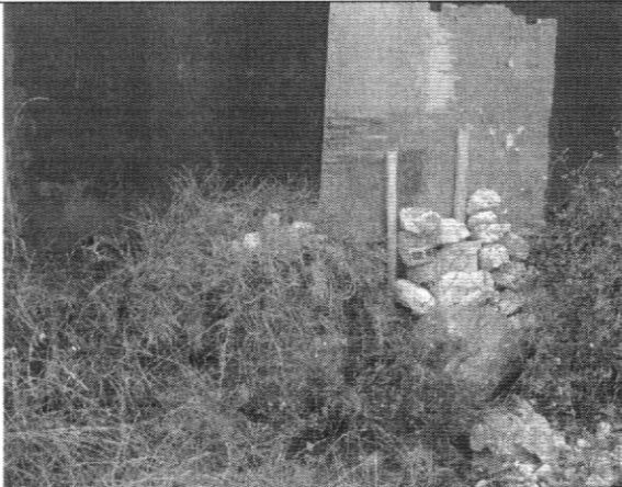
Fotografía No. 3. Parte posterior de la vivienda con nomenclatura Carrera 74G # 75B-15.
