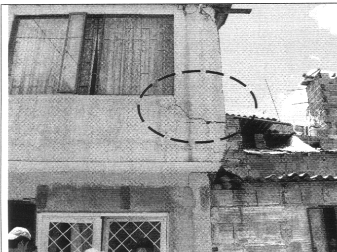
Fotografía 1. Detalle del agrietamiento del muro de fachada del segundo nivel posiblemente debido a la deflexión de la placa de entepiso y al impacto dinámico generado por el vehículo.
