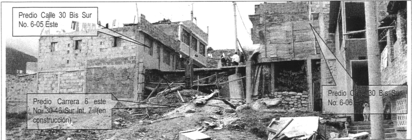
Fotografía 1. Vista general del desprendimiento de suelo en talud de corte, de los predios afectados de la Calle 30 Bis Sur No. 6-05 Este, Calle 30 Bis Sur No. 6-06 Este y del predio en construcción de la Carrera 6 este No. 30-46 sur.
