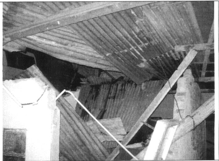
Fotografía 2. Interior de la vivienda ubicada en la Carrera 16 # 33 - 18 Sur (Nueva), donde colapsó la cubierta y algunos muros de la misma.
