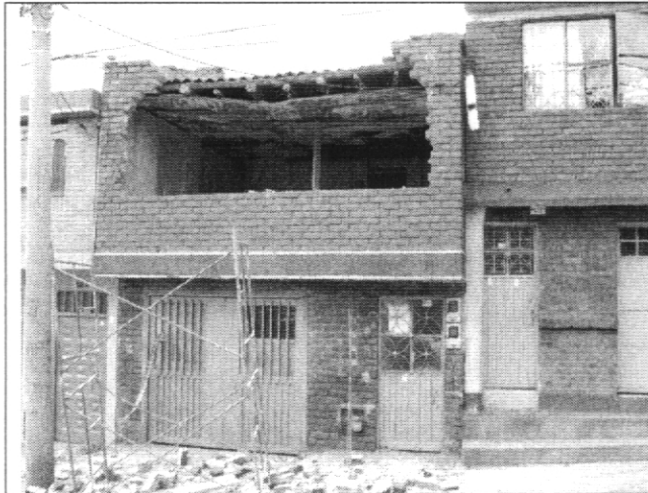
Fotografía 1. Vista frontal de la vivienda ubicada en la Calle 27 Sur # 1B - 26 (Nueva). Colapso parcial del muro fachada del segundo nivel.
