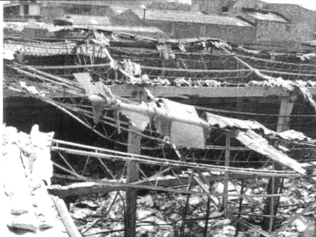
Fotografía 3. Colapso de la cubierta en tejas de asbesto cemento y cercha metálica. Bodega ubicada en la Calle 36 Sur # 71 – 86 (Antigua).
