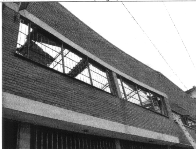
Fotografía 4. Pérdida de verticalidad exagerada del muro del segundo nivel en la fachada de la bodega ubicada en la Calle 36 Sur # 71 – 86 (Antigua).
