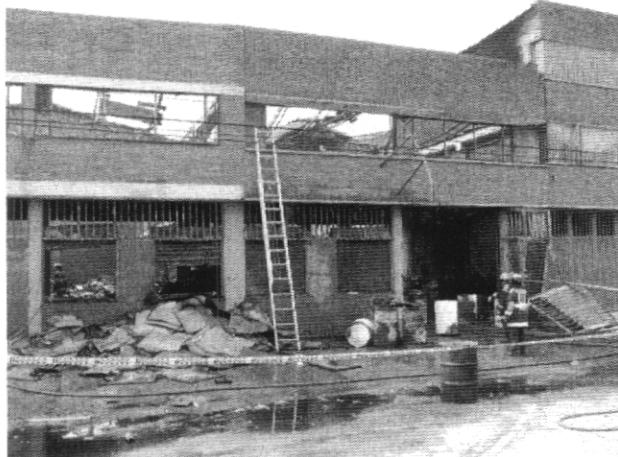
Fotografía 1. Vista frontal de la bodega de material de reciclaje donde se presentó el incendio, ubicada en la Calle 36 Sur # 71 – 86 (Antigua).
