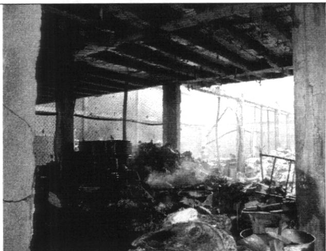
Fotografía 2. Daños en los elementos estructurales al interior de la bodega ubicada en la Calle 36 Sur # 71 – 86 (Antigua).
