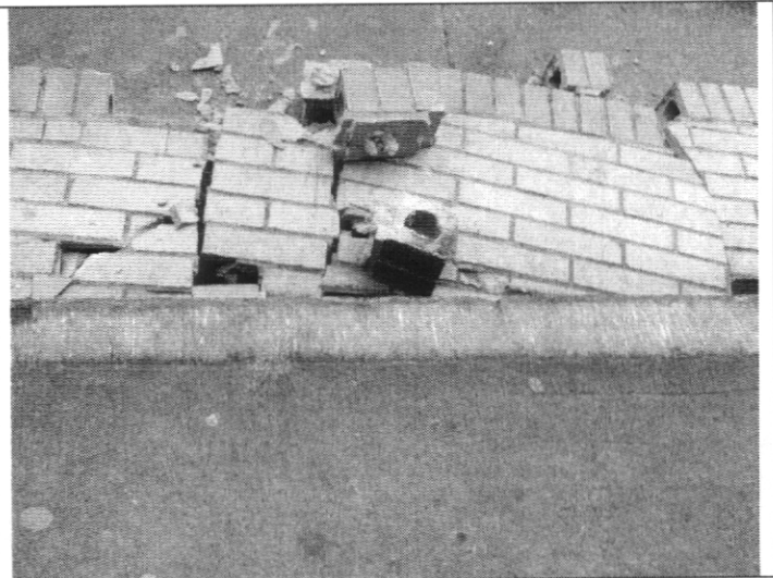
Fotografía 2. Detalle del muro baranda colapsado, no hay evidencia de refuerzo pasante o empotramiento en la base del muro.
