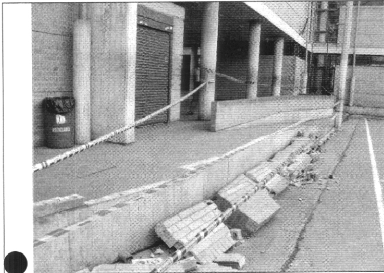
Fotografía 1. Muro baranda colapsado, de una longitud de 12 m y una altura de 80 cms, sobre una rampa que alcanza una altura máxima de 80 cms. Colegio La Gaitana ubicado en la Transversal 126 # 134-86 (Nueva).
