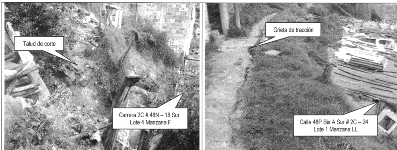
Foto 1. Vista lateral del talud que genera empujes activos a la vivienda de la Carrera 2 Este # 23 - 76, por avance en proceso de remoción en masa de carácter general que se presenta en la ladera.
