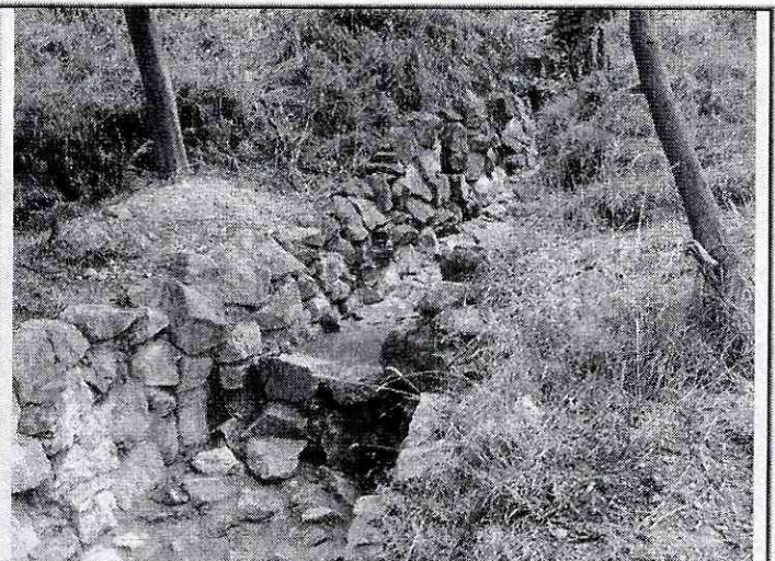
Fotografía 4. Obras de control de drenaje del talud de la antigua explotación minera localizado al costado oriental de las Torres North Point. Se aprecia una zanja longitudinal con disipadores de energía.
