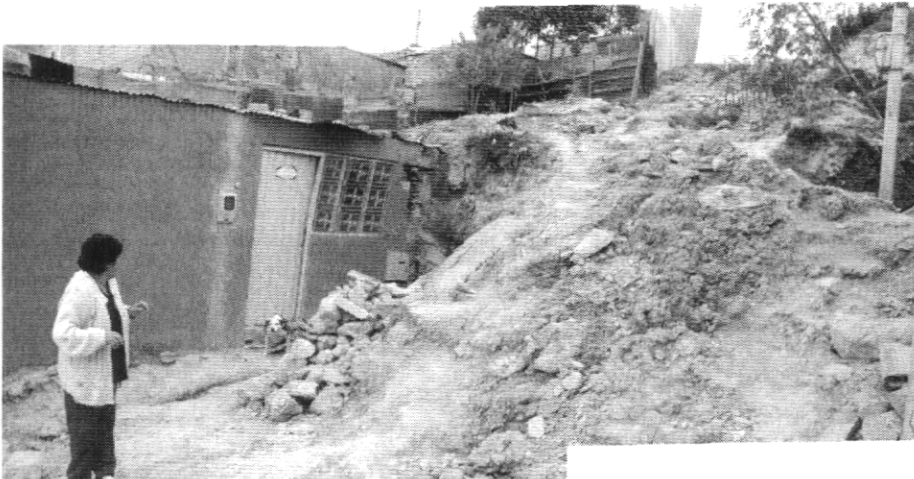
Fotografía 1. Vista del frente de la vivienda de la Carrera 77A # 61C-38 Sur (lote 14). Se observa el grado de afectación en la integridad del muro de este costado (occidental), debido al empuje de la masa inestabilizada por el deslizamiento translacional
