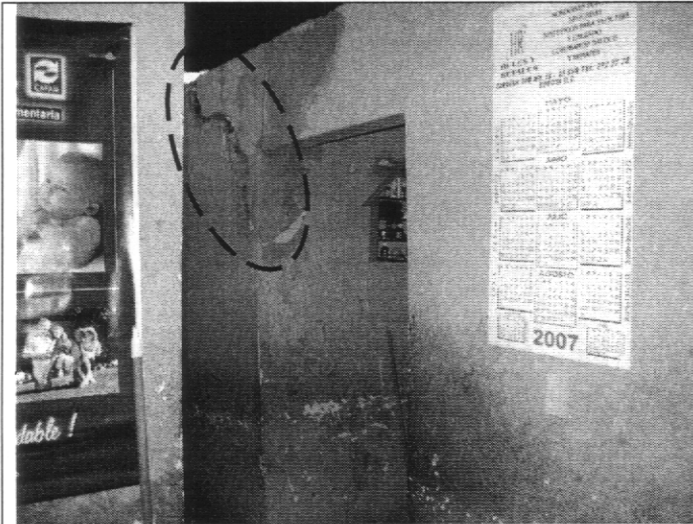
Fotografía 1. Agrietamientos en la zona central al interior de la vivienda con aberturas mayores a 5cm.
