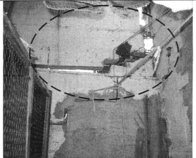
Fotografía 2. Agrietamientos mayores a 5cm en muros del costado posterior de la vivienda con amenaza de colapso.
