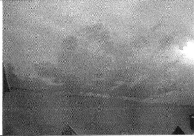
Fotografía 4. Vista del cieloraso del segundo nivel de la vivienda ubicada en la Carrera 2 No. 31-38 que evidencia humedad
