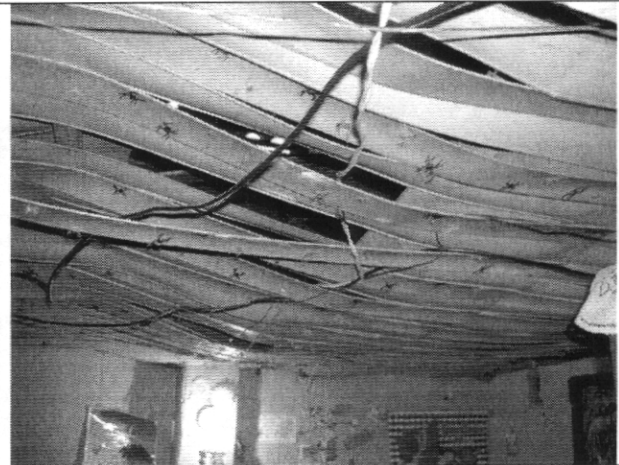
Fotografía 6. Vista del hundimiento del cieloraso compuesto por láminas metálicas delgadas en la parte posterior del predio de la Carrera 1A No. 31-31
