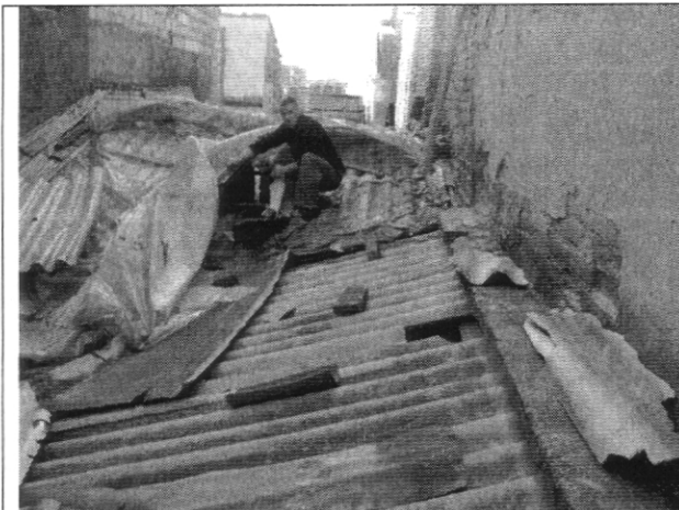
Fotografía 5. Vista de la cubierta en tejas de asbesto cemento, del predio identificado con la nomenclatura Carrera 1A No. 31-31. Nótense algunas tejas rotas. Al fondo, colindante con la parte trasera de este predio, se ubica la vivienda incinerada
