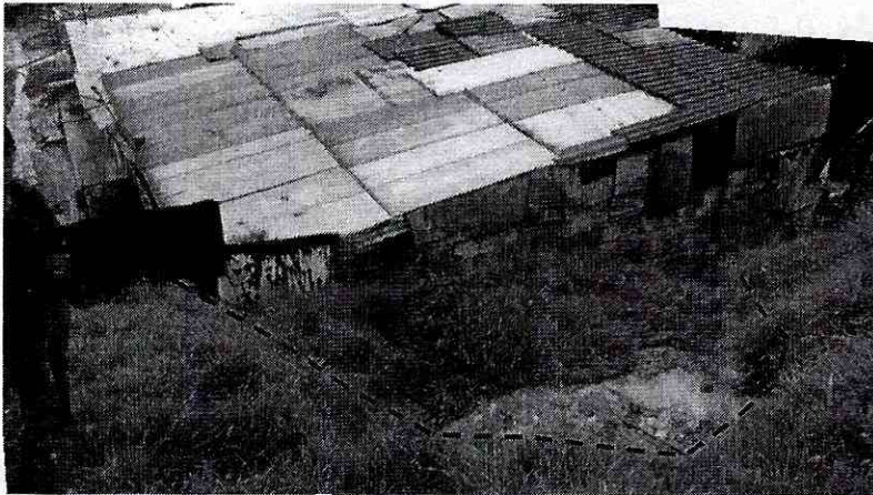
Fotografía 1. Vista del deslizamiento rotacional en el talud de corte casi vertical conformado en un relleno antrópico perteneciente al predio aledaño a la vivienda inspeccionada, el cual corresponde con una finca, nótese el volumen aproximado de material inestabilizado (4 m 3 ). Se muestra también la vivienda ubicada en la Calle 64C Sur No. 5A-24 Este. Se resalta el escarpe del fenómeno de inestabilidad
