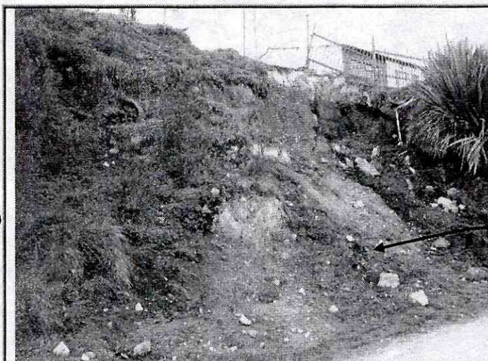
Fotografía 1. Talud en el que se presentó un flujo de tierras debido a la saturación, que afectó el cerramiento de la Escuela Santa Rosa de Bodega.
