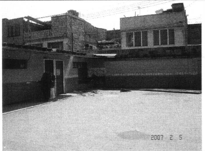
Fotografía 2. Vista general de la escuela camilo Torres y del predio de la Carrera 68B No. 38F-60 Sur donde habita el señor Marcos Ducuara. Observese el colapso de la cubierta del predio de la Carrera 68B No. 38F-60 Sur.
