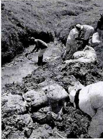
Fotografía 12. Vista de las obras para completar la construcción del jarillón para protección de la orilla del canal de desviación del cauce de la quebrada Santa Rita. Actividades realizadas por personal de IDIPRÓN
