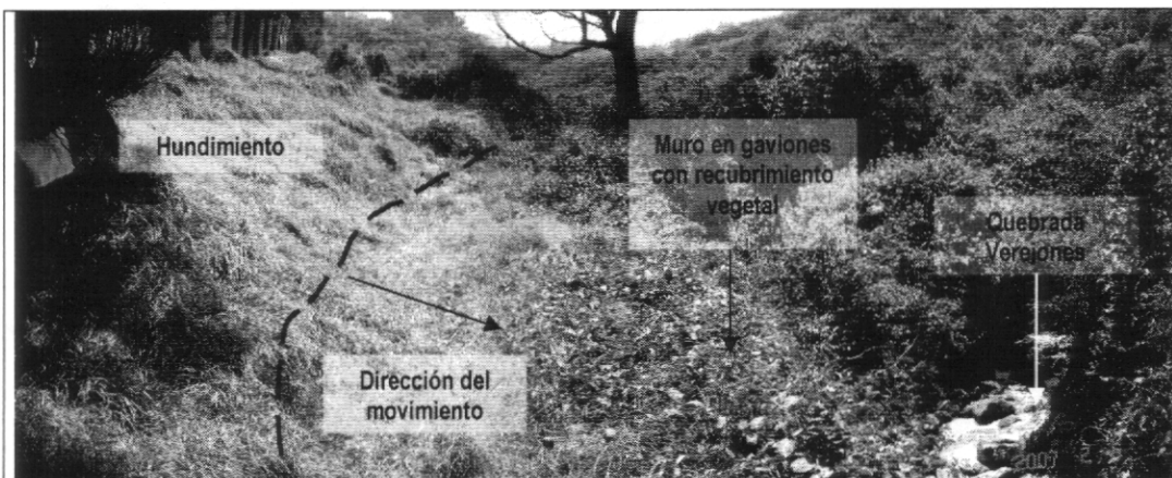
Fotografía 3 Panorámica del muro de gaviones con recubrimiento vegetal y de la quebrada Verejones. Nótese el hundimiento debido a los procesos de inestabilidad de la margen derecha.
