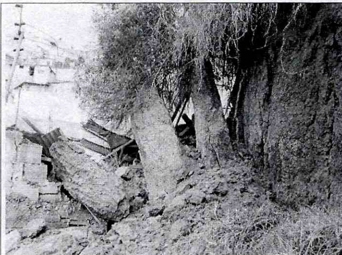
Fotografía 1. Aspecto de las cuñas de suelo desprendidas en la parte posterior del predio de la Calle 55 Bis Sur # 5A – 16.
