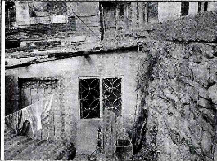
Fotografía 1. Vivienda donde habita la señora Ana Lucía Isaza. Carrera 1 G # 42 A - 10 Sur. Nótese cómo se encuentra unida la construcción al talud de corte superior, protegido por un muro en piedra pegada.
