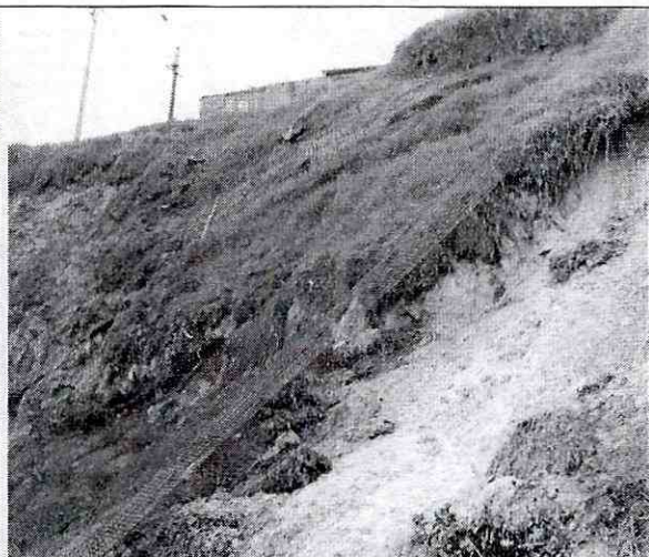
Foto 4. Detalle de las afectaciones en la geomalla principalmente. (Evento 65683)
