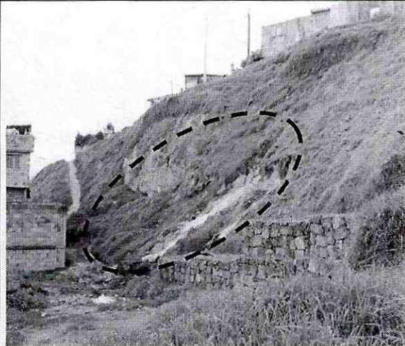
Foto 8. Zona afectada de la obra localizada frente a la Carrera 18 K con Calle 63 Sur. (Evento 65683)
