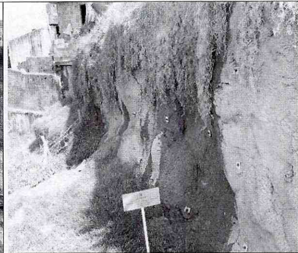
Foto 4. Detalle del costado derecho de la obra sin afectación. Nótese la humedad sobre la cara del talud. (Evento 65844)
