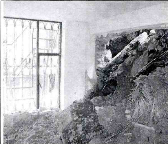
Foto 7. Colapso de muro lateral en el predio 2. (Evento 65844)
