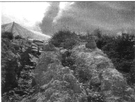
Foto 9. Taludes de corte con evidencia de erosión por intemperismo.
