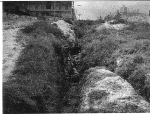
Foto 10. Zajones de escorrentía superficial de aguas servidas.
