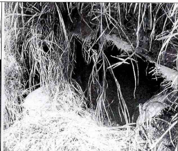
Foto 2. Detalle del desconfinamiento en la parte posterior de la vivienda donde habita la Señora Emma Jerez.
