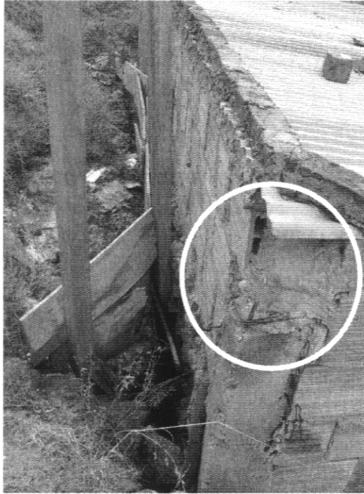
Fotografía 3. Contacto entre el material deslizado del talud de corte y el muro de la parte posterior de la vivienda. Nótese la deficiencia en el confinamiento vertical
