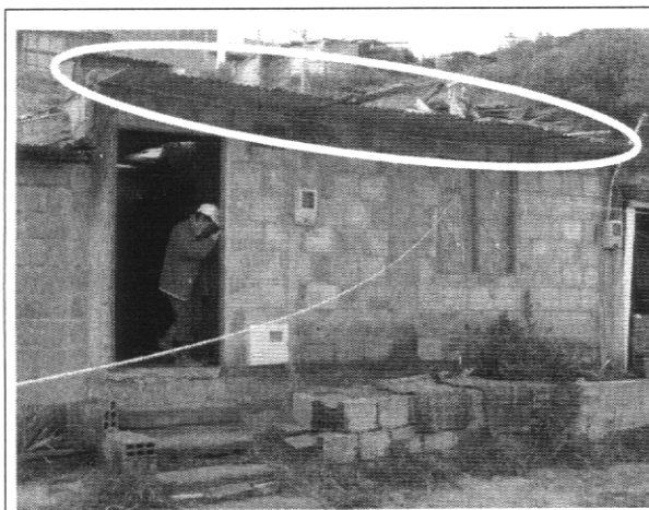
Fotografía 1. Vista frontal de la vivienda ubicada en la Carrera 16 Bis B No. 80 – 44 Sur. Nótese la ausencia de confinamiento horizontal
