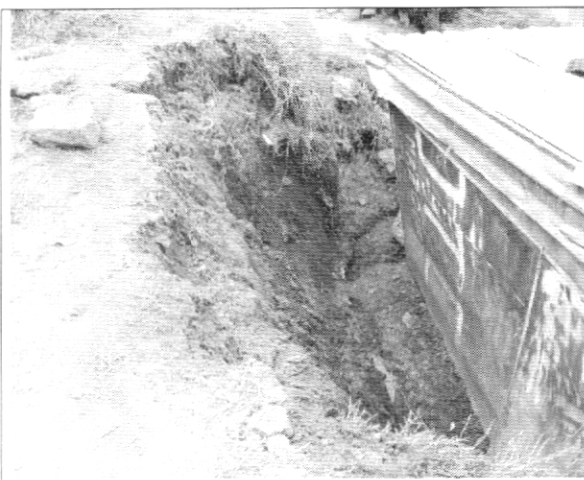
Foto 3. Vivienda donde habita la familia de la Señora Edna Pérez. Manzana 23 Lote 36. Se observa el talud de corte.
