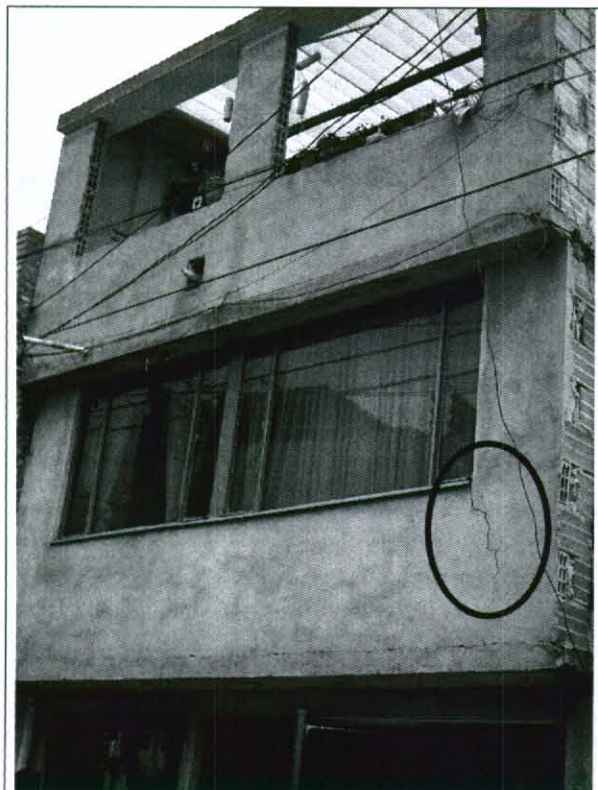
Foto 1. Fachada de la vivienda y fisuras en fachadas.
