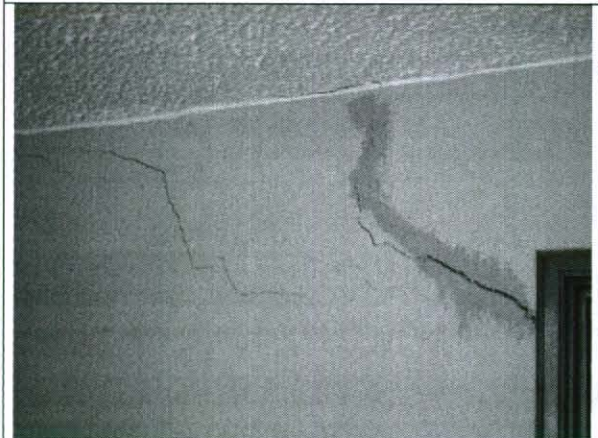
Foto 3. Estado de fisuración moderada en muros interiores en piso 2.
