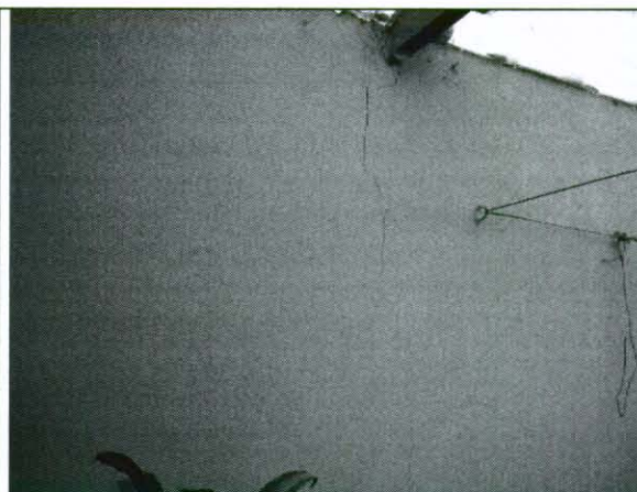
Foto 6 Estado de fisuración moderado en muros interiores en tercer piso.
