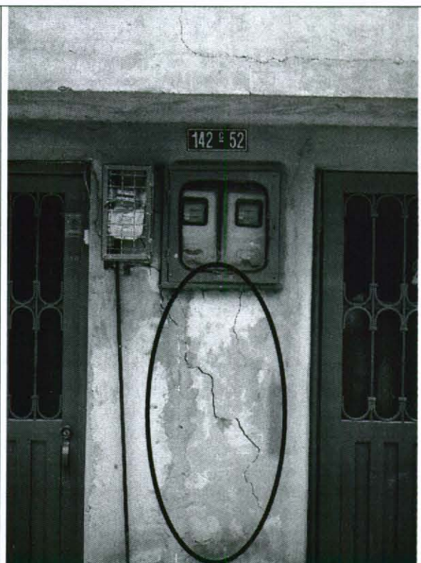
Foto 2. Evidencia de fallas en muros de fachada.
