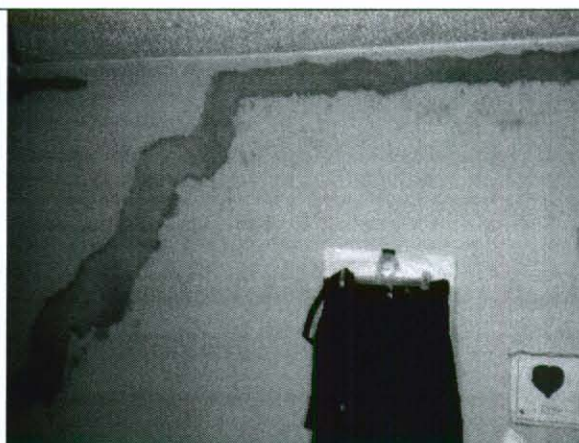
Foto 8. Fisuras ya reparadas.
