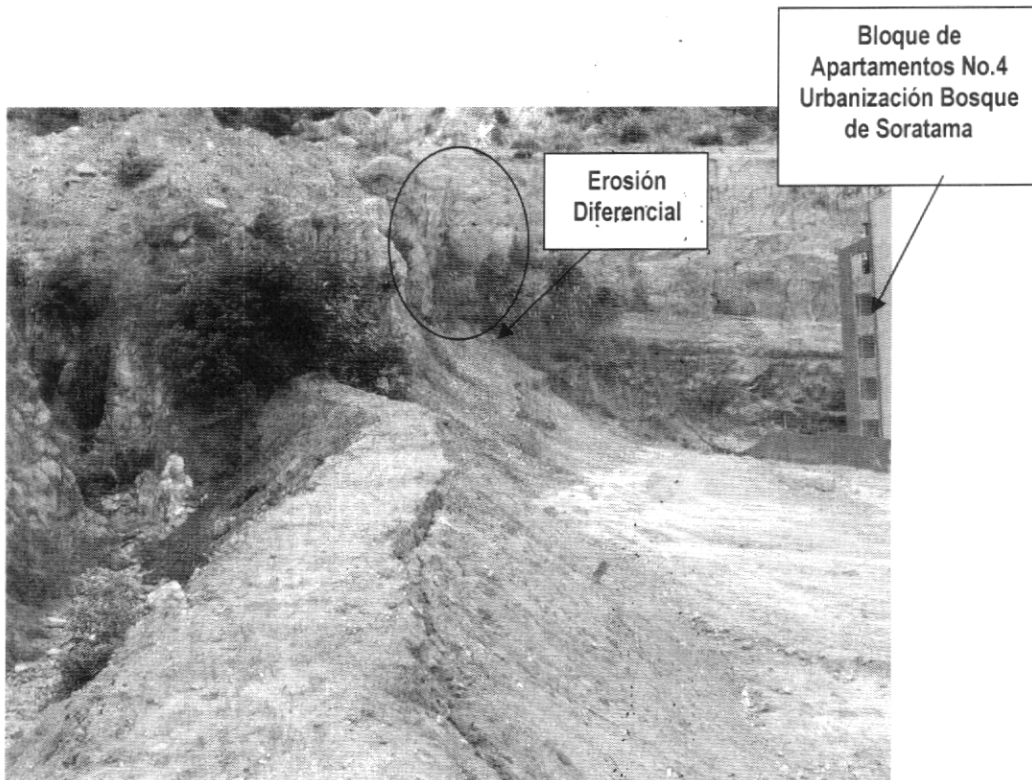
Foto 1 El ovalo señala un bloque potencialmente inestable ubicado en el costado norte del talud oriental
