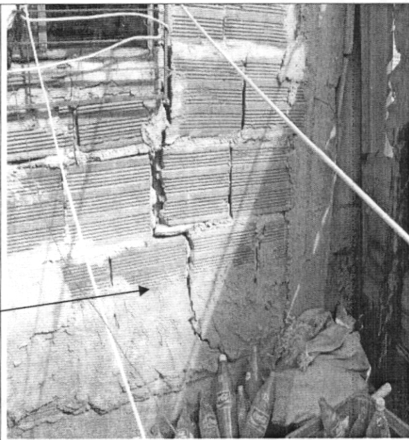
Foto 4. Parte posterior de la vivienda. Detalle de grieta del muro en su parte inferior,
