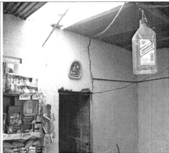
Foto 2. Muros interiores en su mayoría presentan grietas y/o fisuras.
