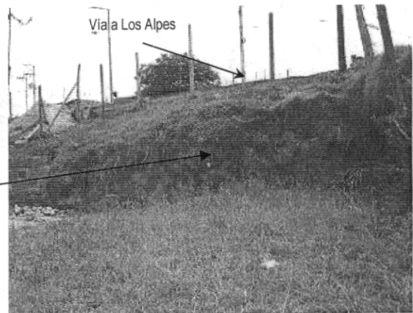
Fotografía 6. Talud localizado hacia el costado occidental del predio 14 de la Manzana P. Obsérvese el desnivel entre la vía a Los Alpes con el nivel de cimentación de los predios; el escarpe posiblemente corresponde a un antiguo deslizamiento.
