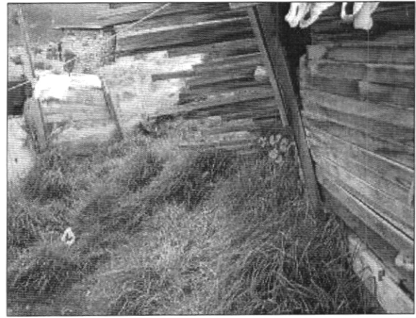
Fotografía 2 Inclinación de las paredes de la vivienda (parte posterior del predio), se aprecia la falta de confinamiento en los apoyos, así como la carencia de cimientos.
