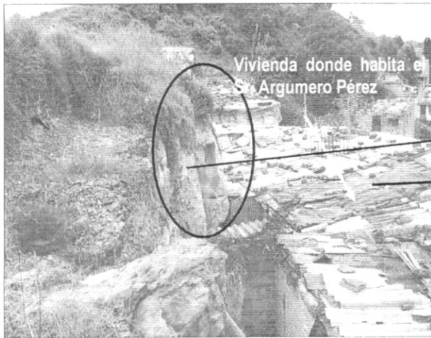
Fotografía 2. Parte alta del barrio Malvinas. Se observan los bloques potencialmente inestables y la vivienda donde habita el Sr. Argumero Pérez
