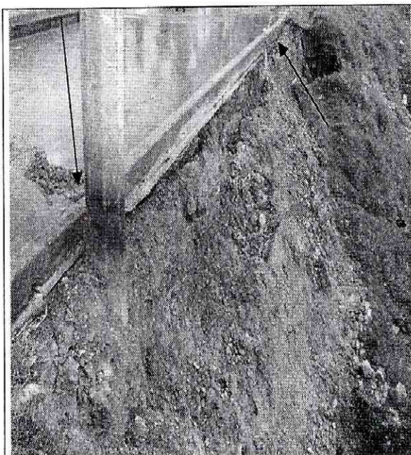
Foto 3. Detalle del deslizamiento del material del talud de la vía. Se observan los desagües sobre el bordillo de concreto. Se observa la pérdida de piso de cimentación de un poste de energía de la Empresa Codensa, sin embargo no se observó inclinación del mismo.
