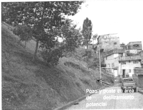
Fotografía 1. Deslizamientos de carácter rotacional sobre suelo residual de arenisca, al fondo la escalera que atraviesa el parque.
