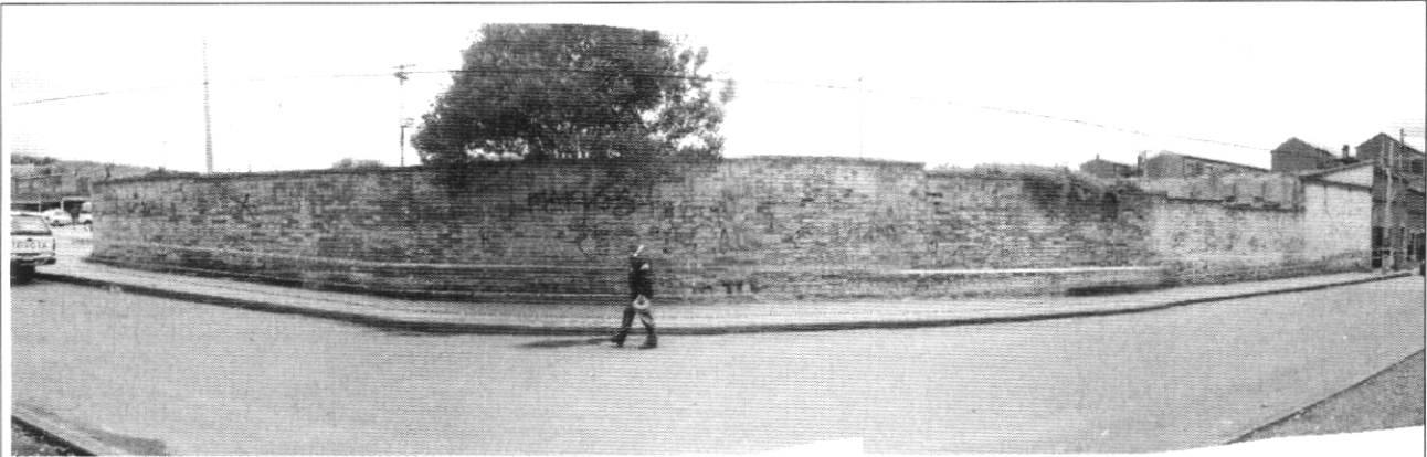
Foto 5. Vista frontal del muro de cerramiento sobre la Calle 18 Sur del predio de la esquina suroccidental de la Carrera 2A con Calle 18 Sur, donde se aprecia el deterioro del mismo y el andén sobre el cual amenaza colapsar.
