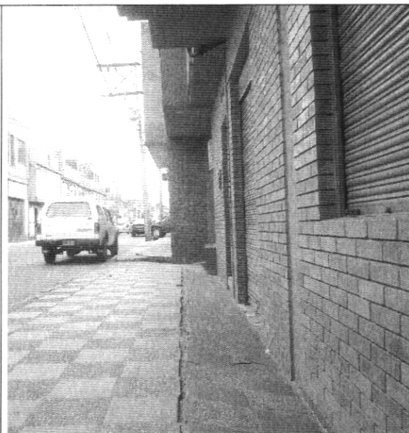
Foto 4. Evidencias de asentamientos en el predio 3, a 50 metros al sur del sitio donde se presentó el hundimiento de la vía.
